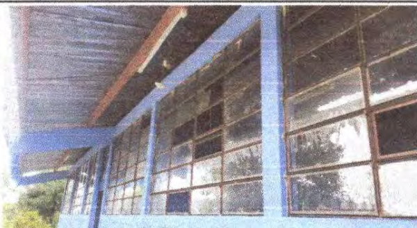
Foto 5: vidriso quebrados, necesario colocar nuevos
