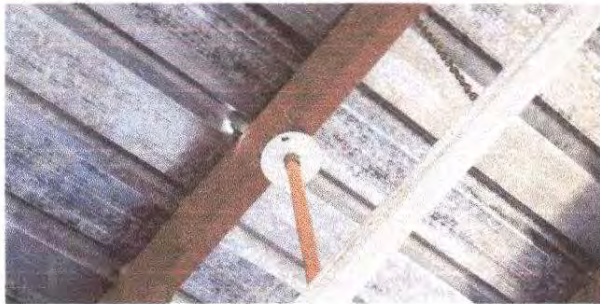
Foto 1: Mal estado del techo es de 2 aguas se pico toda la lamina gotea de maciado en epoca de lluvia
