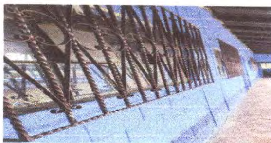
Foto 12: Mal estado de balcones
