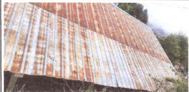
Foto 2: Mal estado del techo es de 2 aguas se pico toda la lamina gotea de maciado en epoca de lluvia
